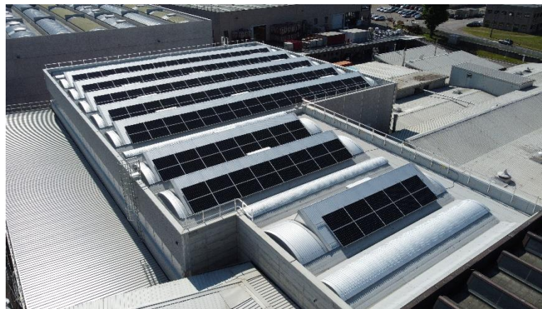
FIGURA 9 - IMPIANTO FOTOVOLTAICO DI GORNATE OLONA
